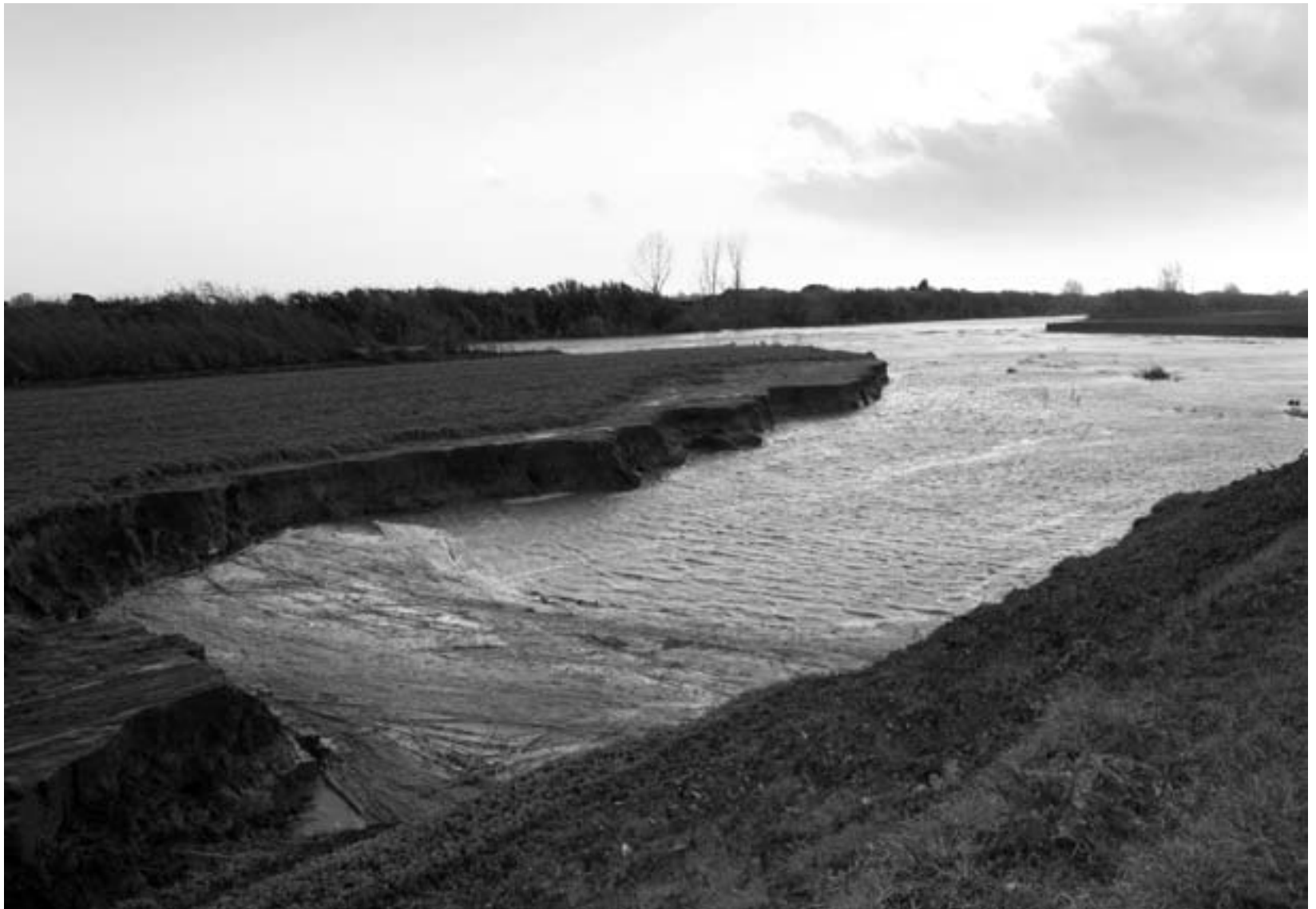
L'argine appena rotto che ha provocato l'esondazione del Serchio dello scorso dicembre (foto Chiara Martina © www.pisanotizie.it)
